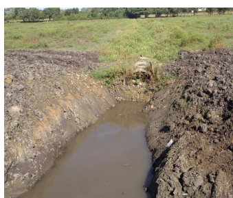
Ouvrage perché et mal entretenu suite au surcreusement du fossé
